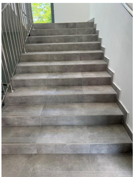
Zdjęcie nr 10: Brak oznakowanych schodów na SOR
